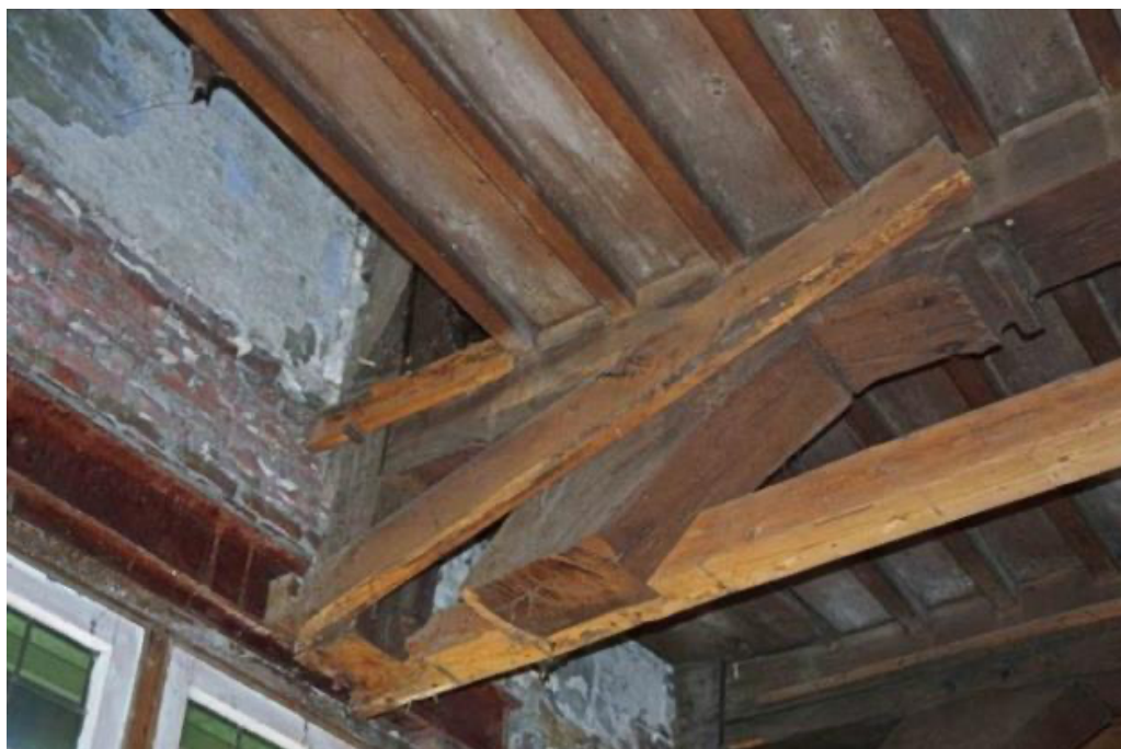
Een monumentaal pand na ontmanteling. Onderzoek naar de constructieve veiligheid in het kader van het herstel.
